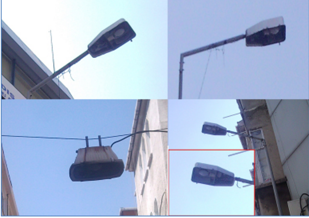
Şekil 12.3: Çalışma sahasının aydınlatma armatürlerinin durumu
