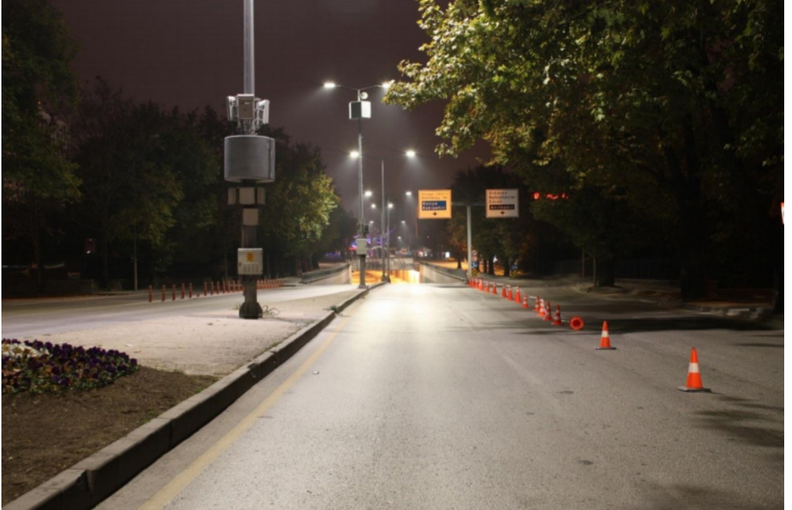
Şekil 10.2: LED dönüşümü yapıldıktan sonra yeni tesisat
