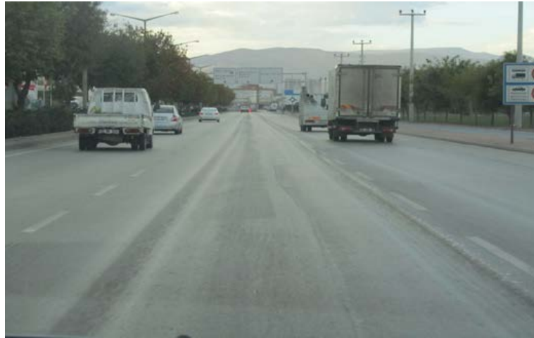
Şekil 4.6: Adana Çevreyolu Caddesinde katkısız bitümlle yapılmış kaplamada tekerlek izi
