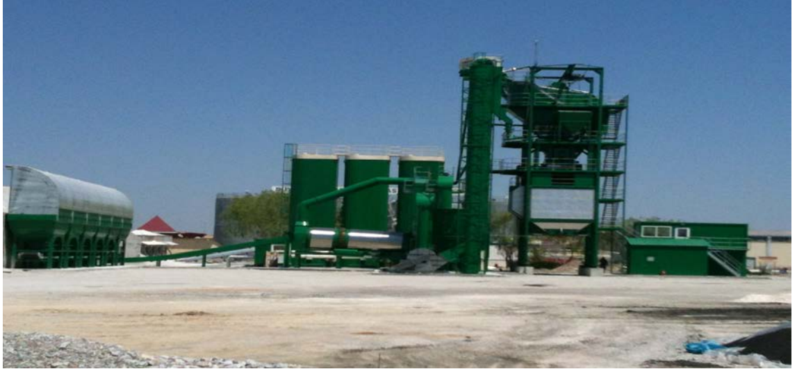
Şekil 4.2: Konya Büyükşehir Belediyesi’ne ait EMAK marka 240 ton/saat kapasiteli asfalt planti.
