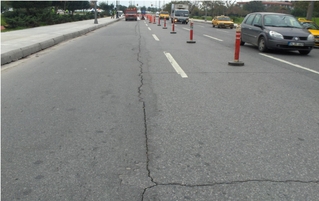
Şekil 4.10: Pendik sahil yolu karayolu üstyapısı bozulma örneği -2
