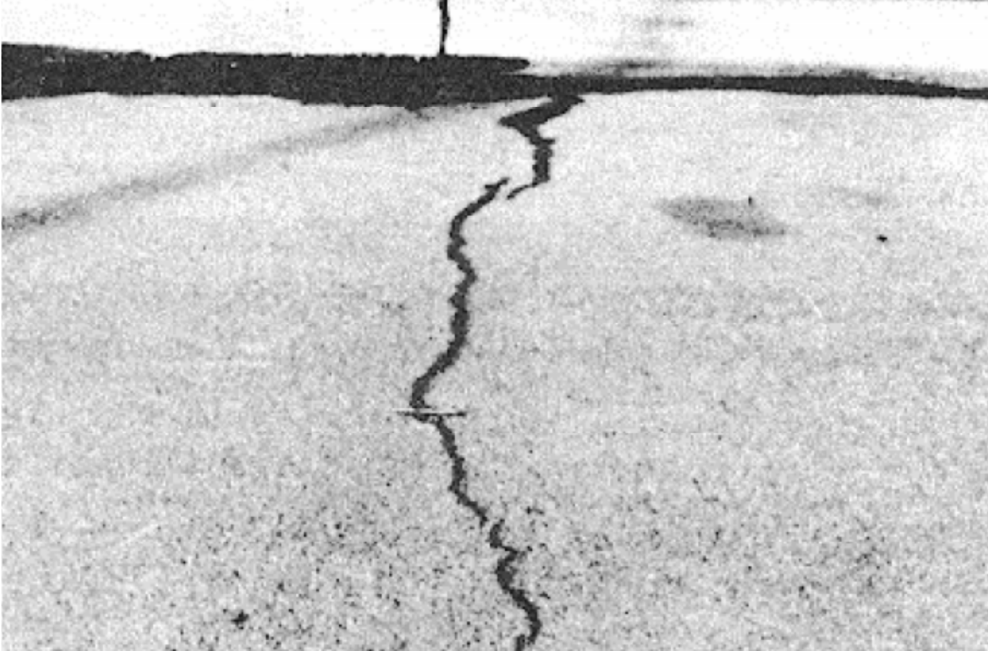
Şekil 3.16: Orta yoğunluklu enine ve boyuna çatlak
