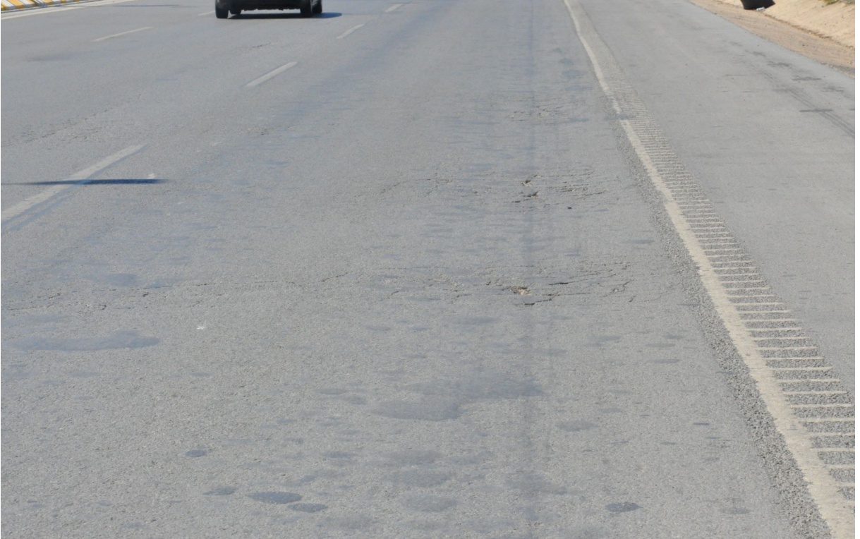
Şekil 4.4: Pendik havaalanı iç yolu karayolu üstyapısı bozulma örneği -2
