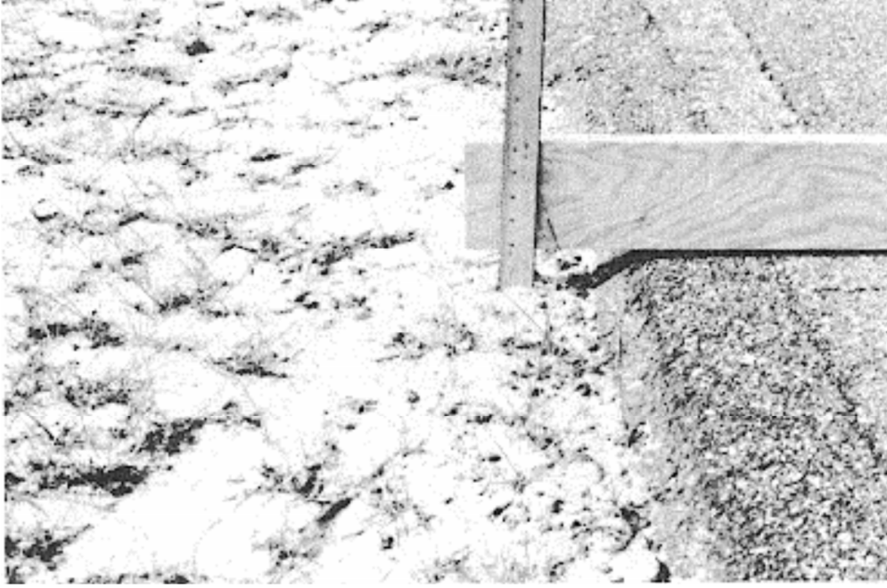
Şekil 3.43: Düşük yoğunluklu kenar/banket düşüklüğü
