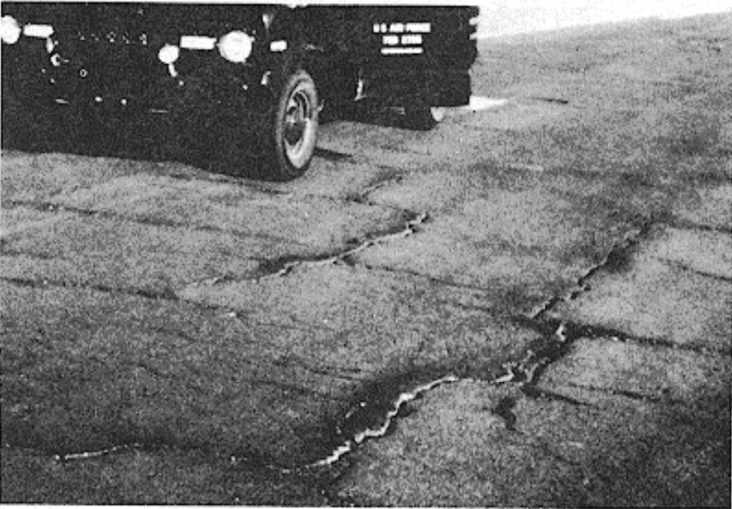
Şekil 3.7: Yüksek yoğunluklu blok çatlak
