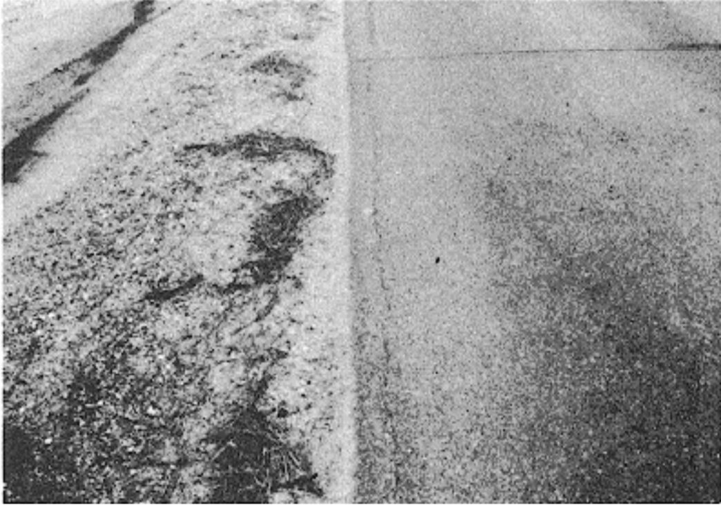
Şekil 3.8: Düşük yoğunluklu kenar çatlağı
