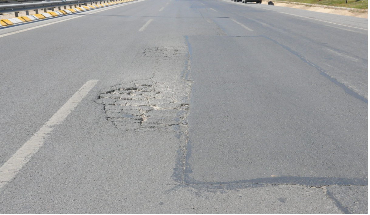
Şekil 4.3: Pendik havaalanı iç yolu karayolu üstyapısı bozulma örneği
