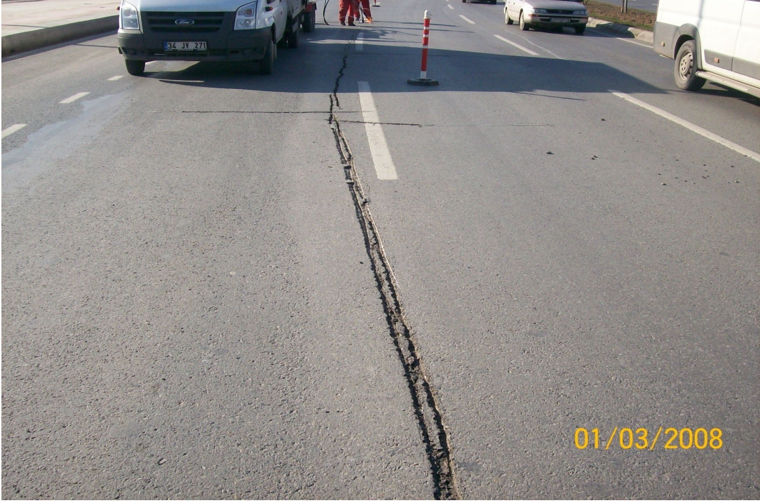
Şekil 4.9: Pendik sahil yolu karayolu üstyapısı bozulma örneği
