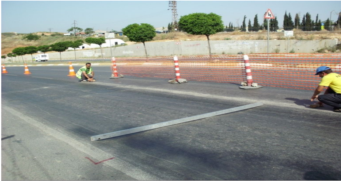
Şekil 4.16: Tuzla Aydınlı Yolu Caddesi karayolu üstyapısı bozulma örneği
