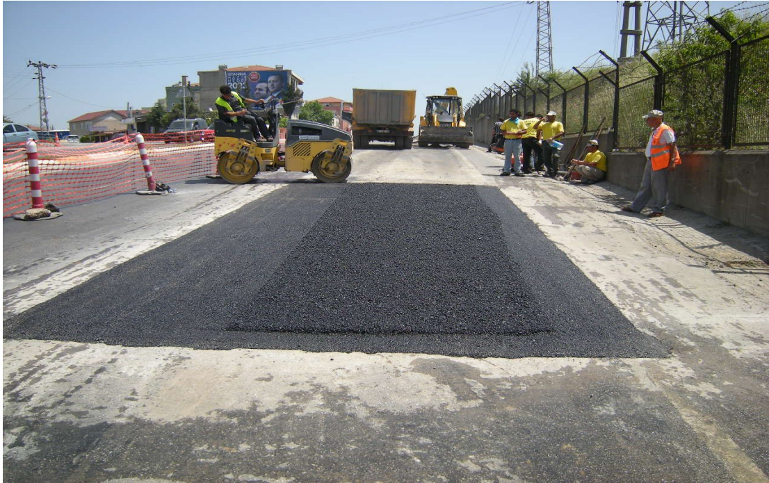
Şekil 4.18: Tuzla Aydınlı Yolu Caddesi karayolu üstyapısı bozulma örneği -3
