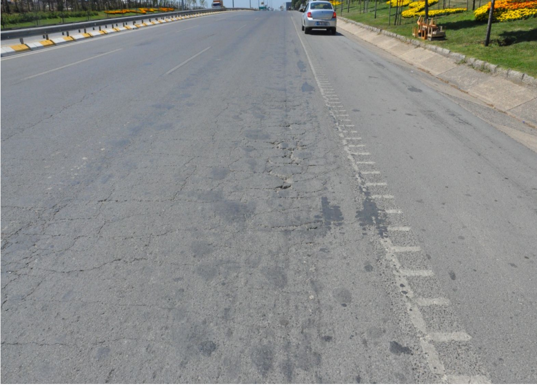
Şekil 3.1: Yorulma çatlakları (timsah sırtı çatlaklar)
