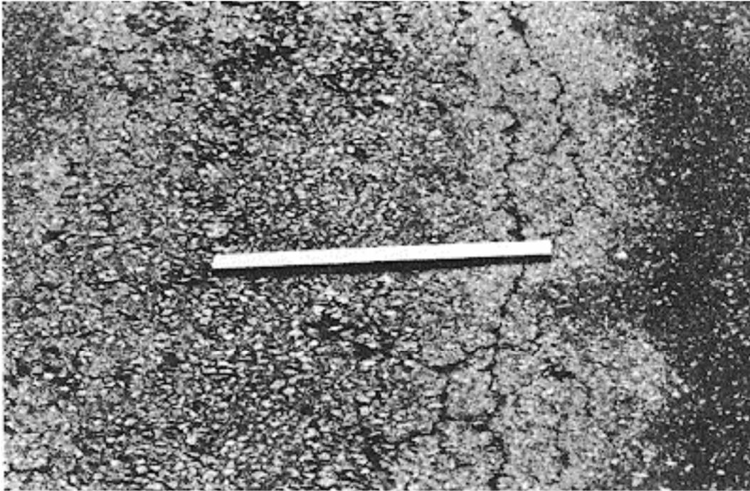
Şekil 3.53: Düşük yoğunluklu sökülme ve ayrışma
