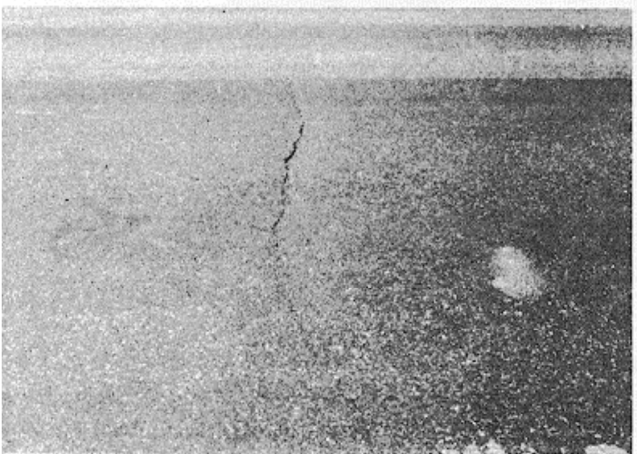
Şekil 3.15: Düşük yoğunluklu enine ve boyuna çatlak
