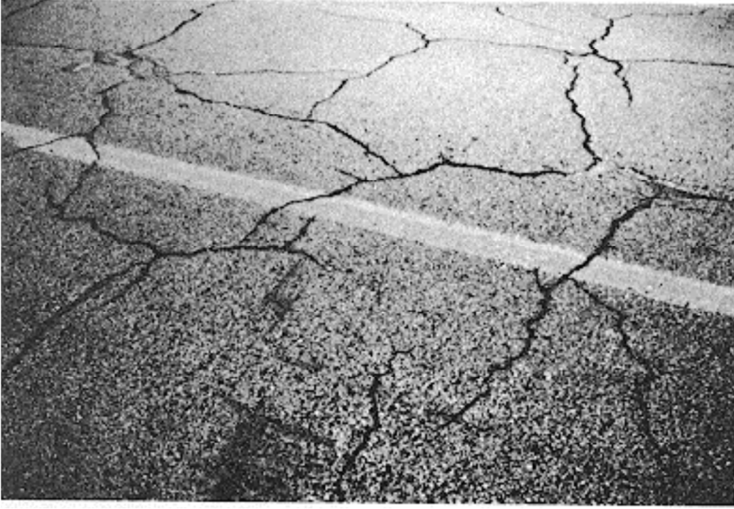
Şekil 3.6: Orta yoğunluklu blok çatlak
