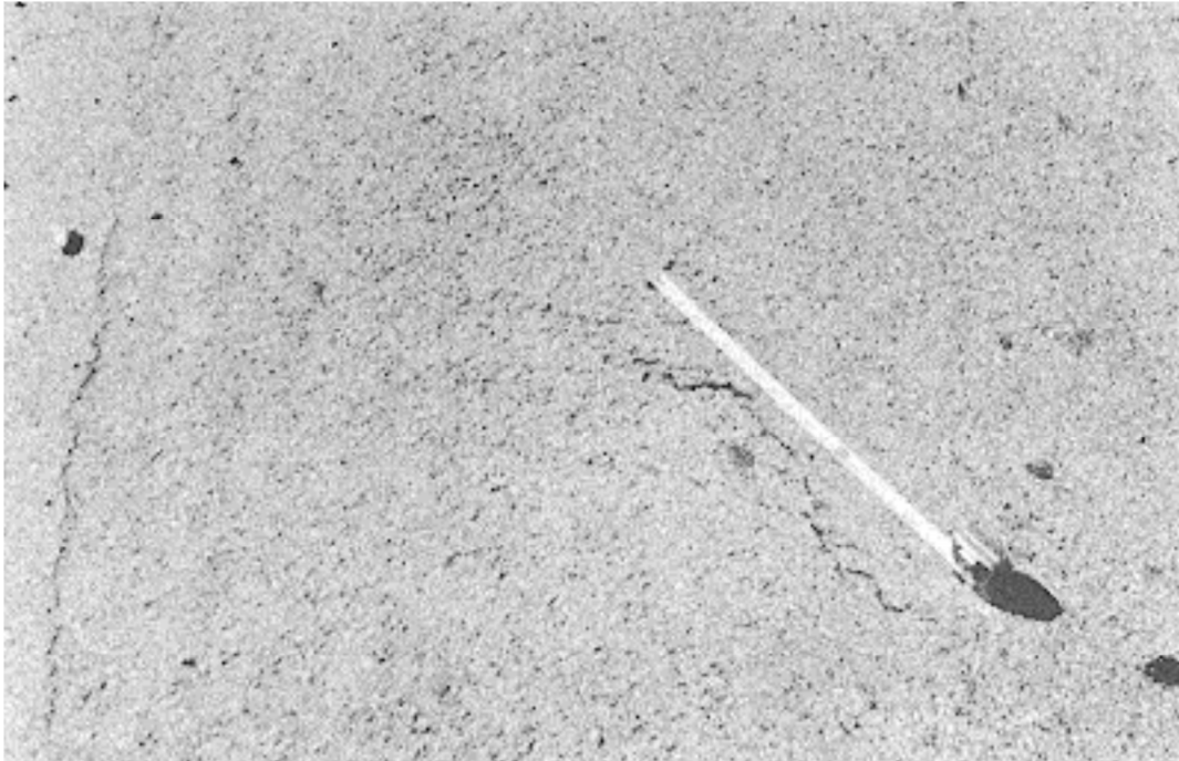
Şekil 3.18: Düşük yoğunluklu tabaka kayması çatlakları
