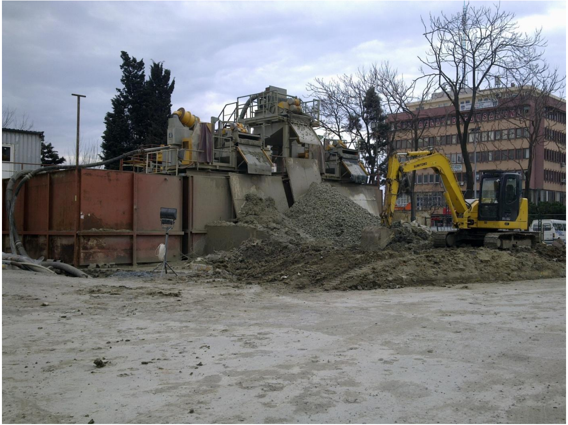
Şekil 5.36: Bentonit Ayrıştırma Ünitesi
