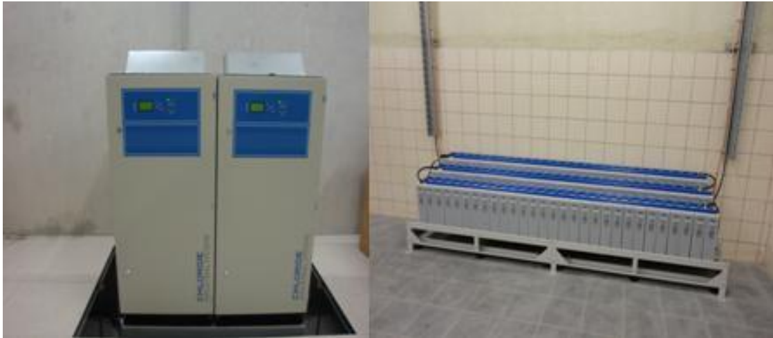
Şekil 4. 12: Ziya Gökalp istasyonu 110 VDC redresör ve aküsü
