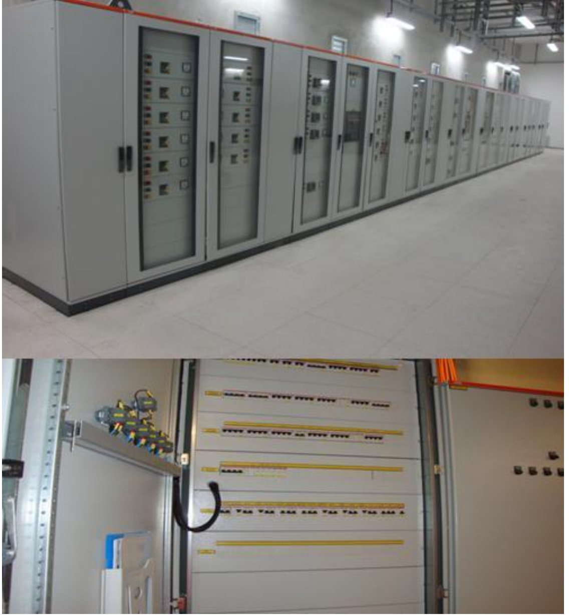
Şekil 4. 10: İkitelli Sanayi istasyonu alçak gerilim ana ve tali dağıtım panoları
