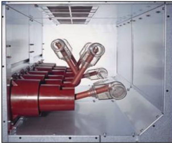
Şekil 4. 18: Orta gerilim hücresinin bara bölmesi
