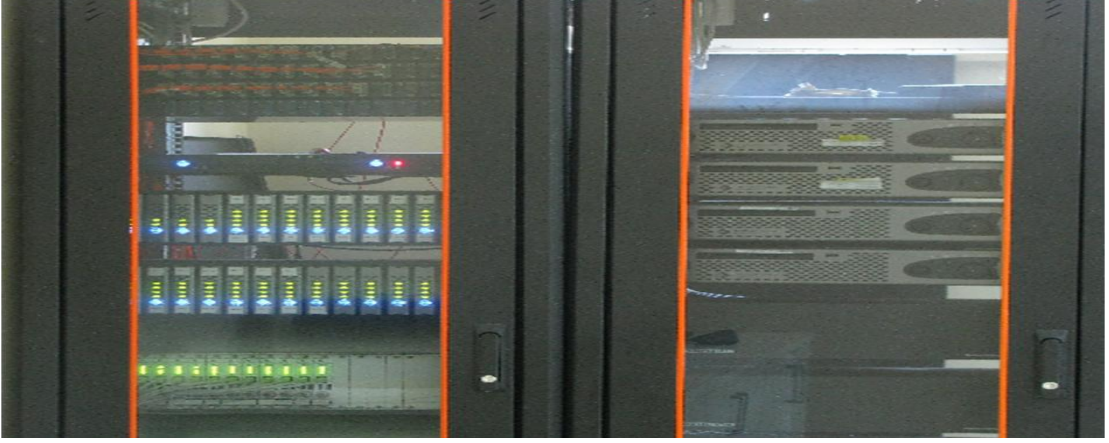
Şekil 6.23: Kağıthane – Dolmabahçe Tüneli SCADA Odası
