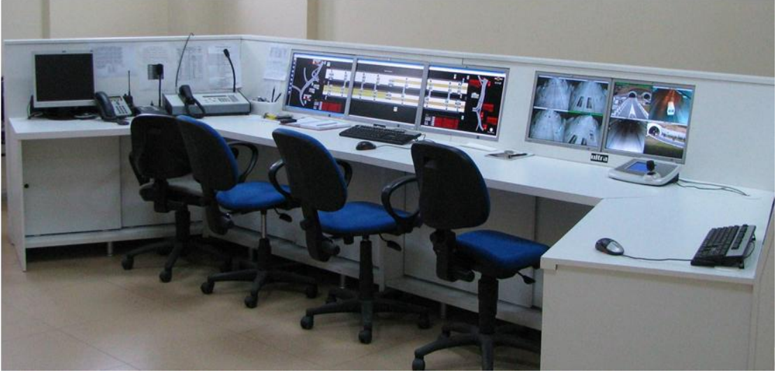
Şekil 6.25: Kağıthane – Dolmabahçe Tüneli Kontrol Merkezi
