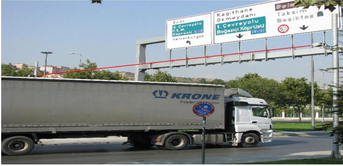
Şekil 6.15: Kağıthane – Dolmabahçe Tüneli Gabari Kontrol Sistemi
