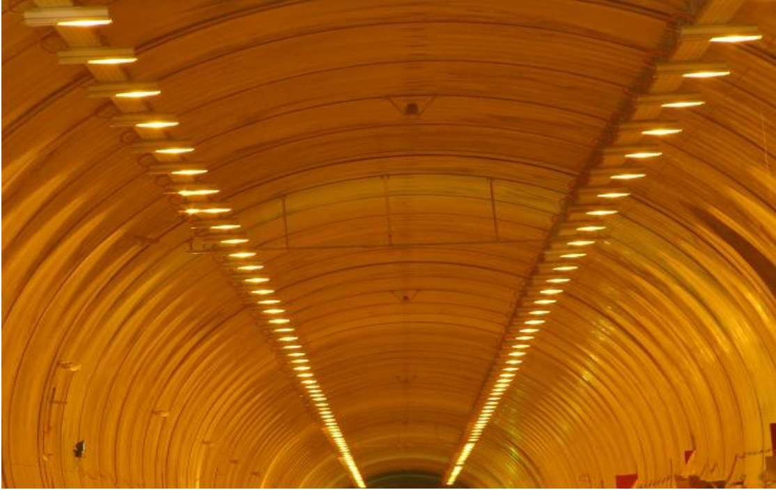
Şekil 6.5: Kağıthane – Dolmabahçe Tüneli Aydınlatma Armatürleri
