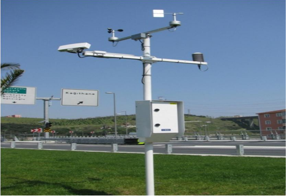
Şekil 6.17: Kağıthane – Dolmabahçe Tüneli Meteorolojik İstasyon
