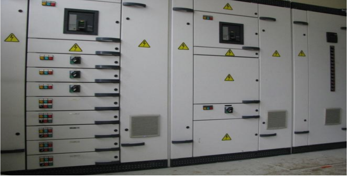
Şekil 6.24: Kağıthane – Dolmabahçe Tüneli SCADA Odası 2
