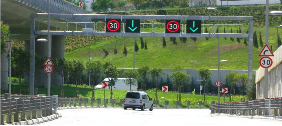
Şekil 6.12: Kağıthane – Dolmabahçe Tüneli Trafik Kontrol Sistemi
