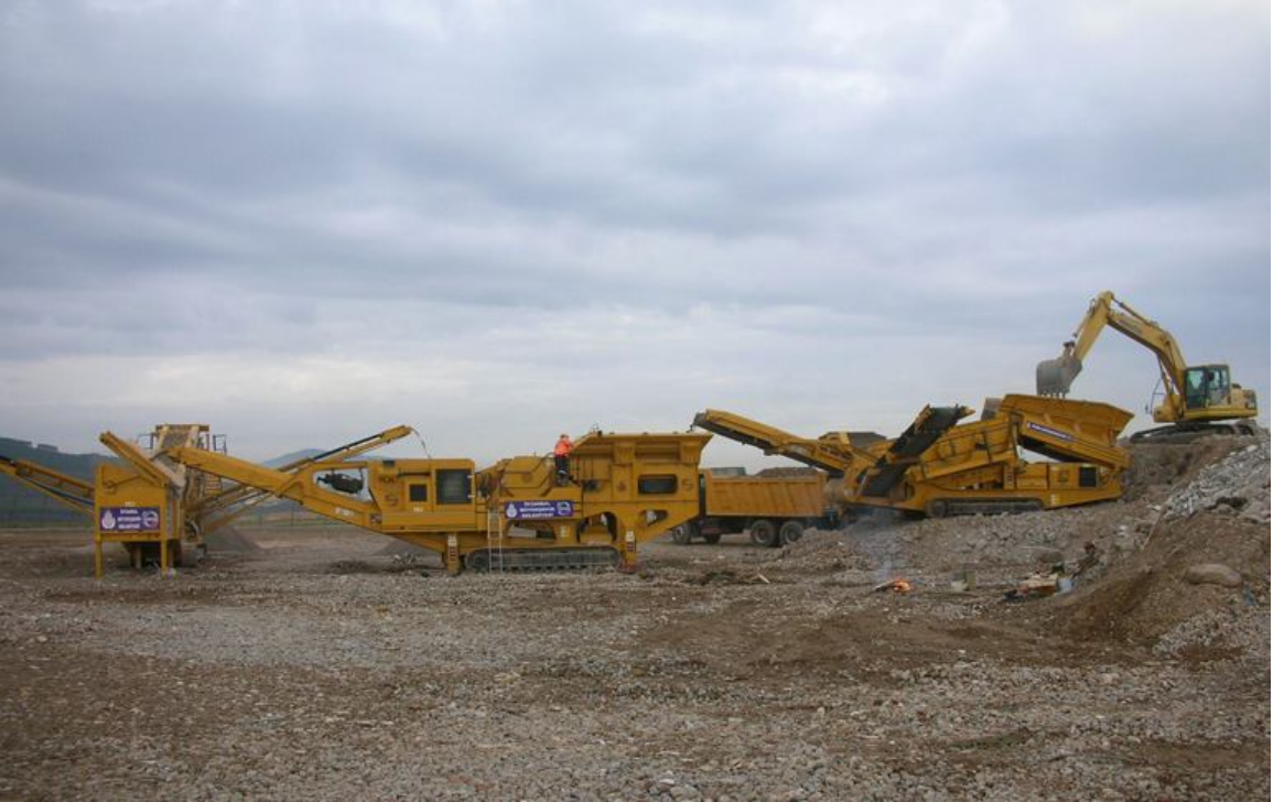
Şekil 4.6: Geri kazanım tesisinde taşıyıcı konveyör sistemler
