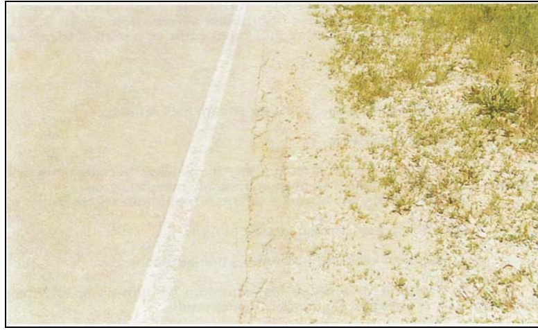
Şekil 4.25 : Ek yeri çatlakı
