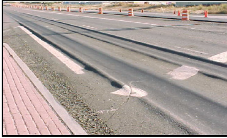
Şekil 4.5 : Tekerlek izi oluşumu ve oluklanma
