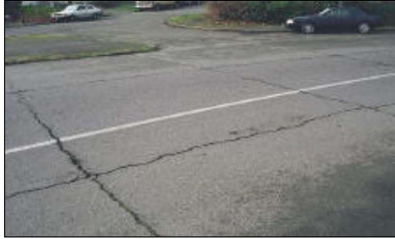
Şekil 4.24 : Yüksek şiddette yansıma çatlakları
