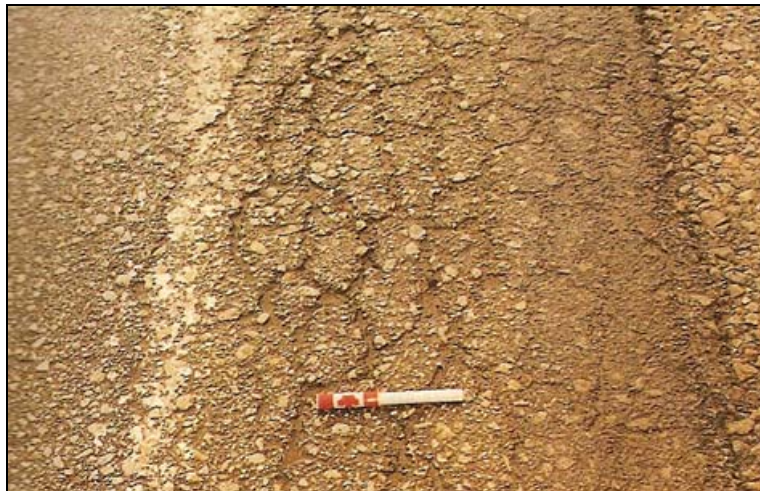
Şekil 4.17 : Yüksek şiddette kenar çatlağı
