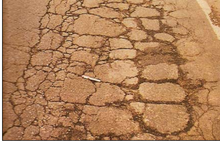
Şekil 4.14 : Yüksek şiddette yorulma çatlağı
