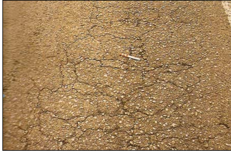
Şekil 4.13 : Orta şiddette yorulma çatlağı
