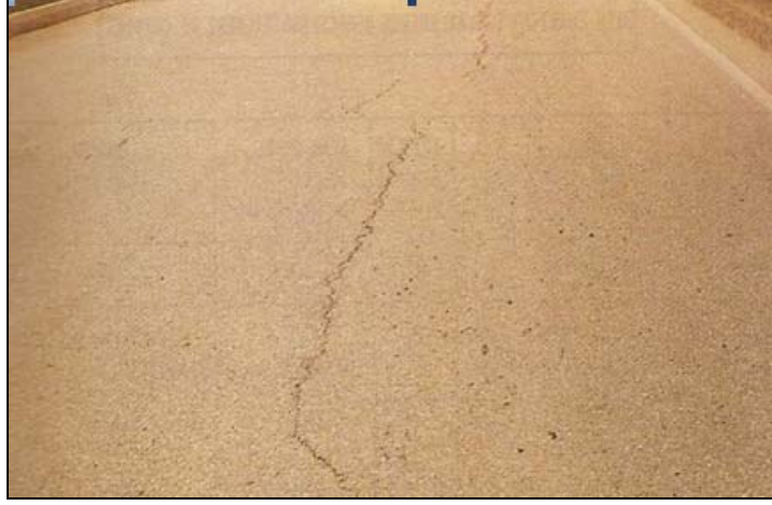
Şekil 4.18 : Hafif şiddette boyuna çatlak
