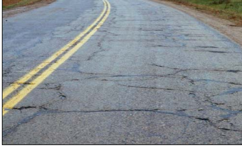
Şekil 4.22 : Orta şiddette blok çatlaklar
