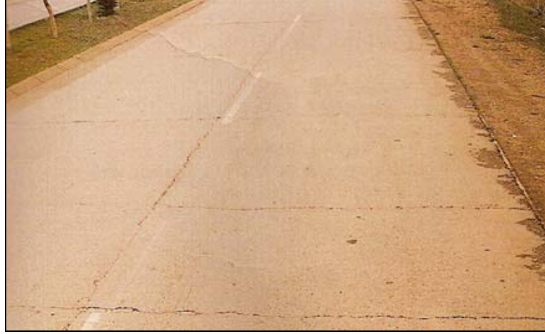
Şekil 4.10 : Yüksek şiddette termal çatlak
