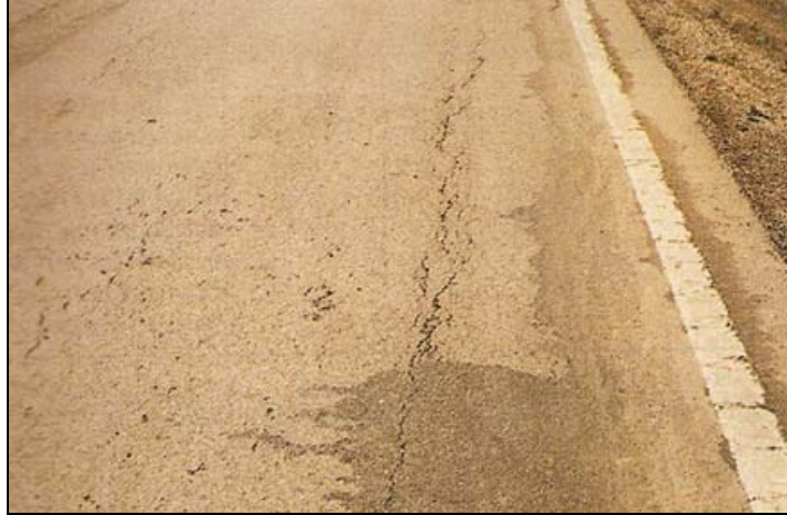
Şekil 4.19 : Orta şiddette boyuna çatlak
