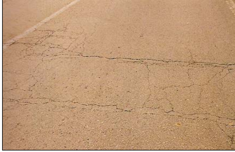
Şekil 4.9 : Orta şiddette termal çatlak
