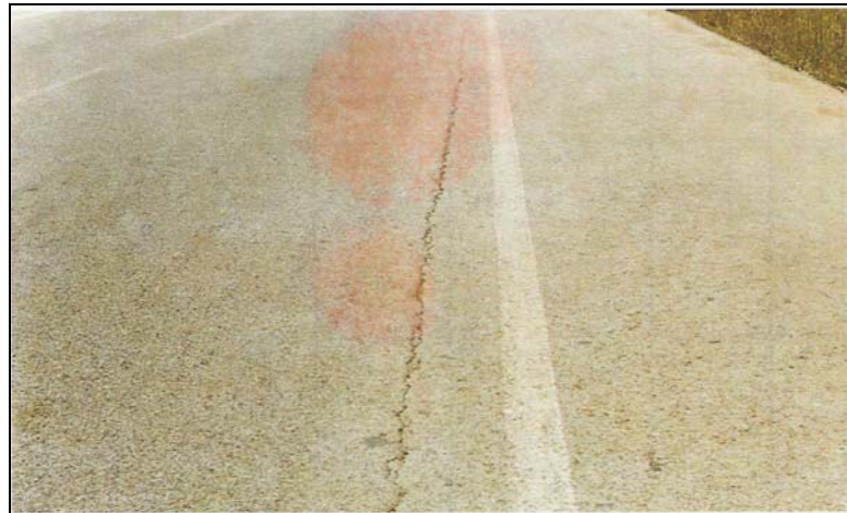
Şekil 4.26 : Ek yeri çatlakı
