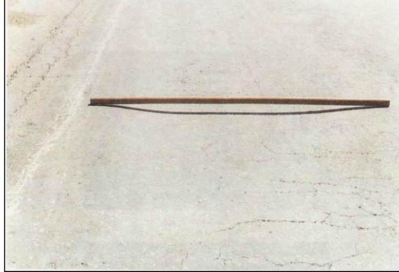
Şekil 4.32 : Zayıf asfalt tabakasında tekerlek izi oluşumu
