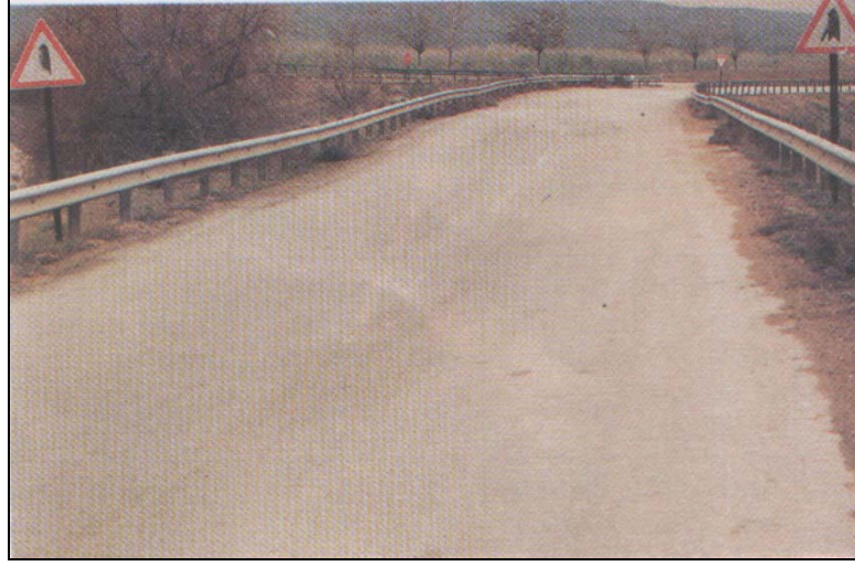
Şekil 4.33 : Zayıf asfalt tabakasında tekerlek izi oluşumu
