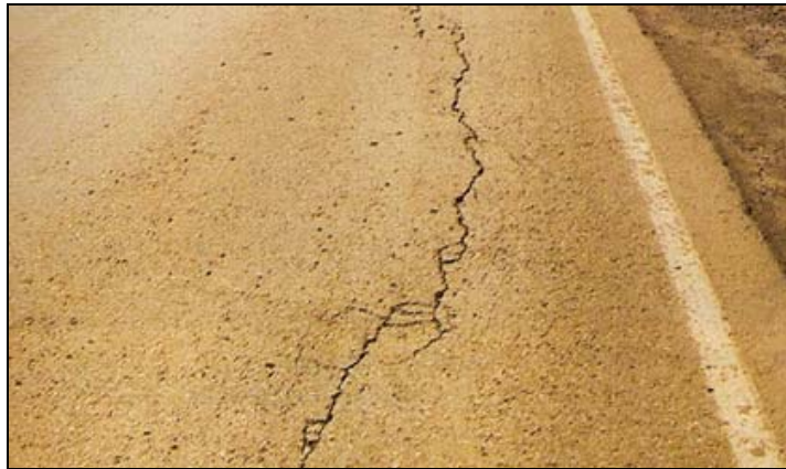
Şekil 4.20 : Yüksek şiddette boyuna çatlak
