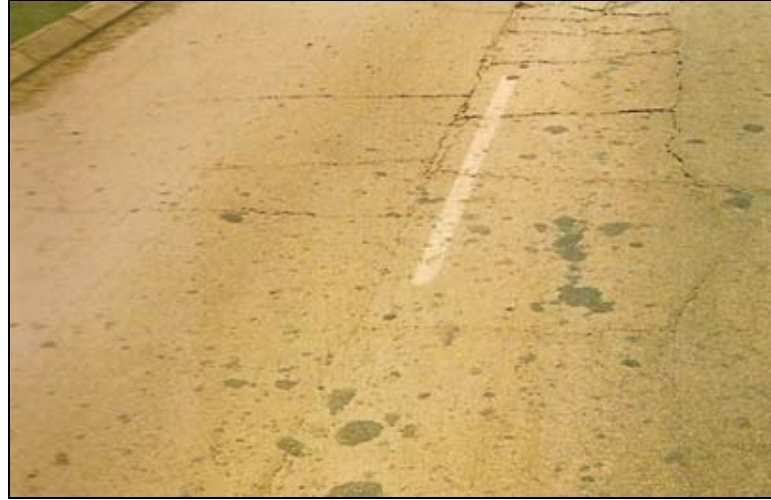
Şekil 4.21 : Hafif şiddette blok çatlakları
