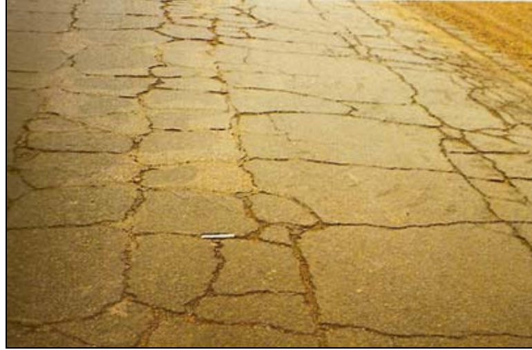
Şekil 4.23 : Yüksek şiddette blok çatlaklar
