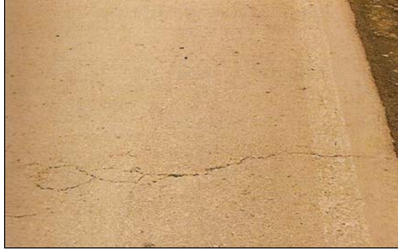
Şekil 4.8 : Hafif şiddette termal çatlak
