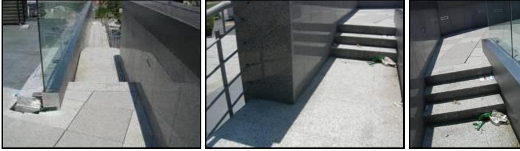
Resim 5.59: Erişimi sınırlayan merdiven uygulaması
