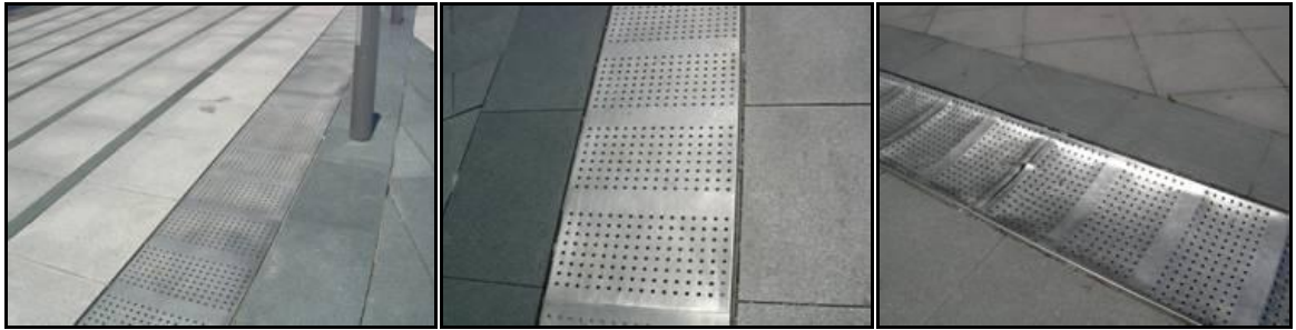
Resim 5.100: Yolda bulunan ızgaraların kaygan yüzeye sahip olması sonucu oluşan engel ve tehlike
