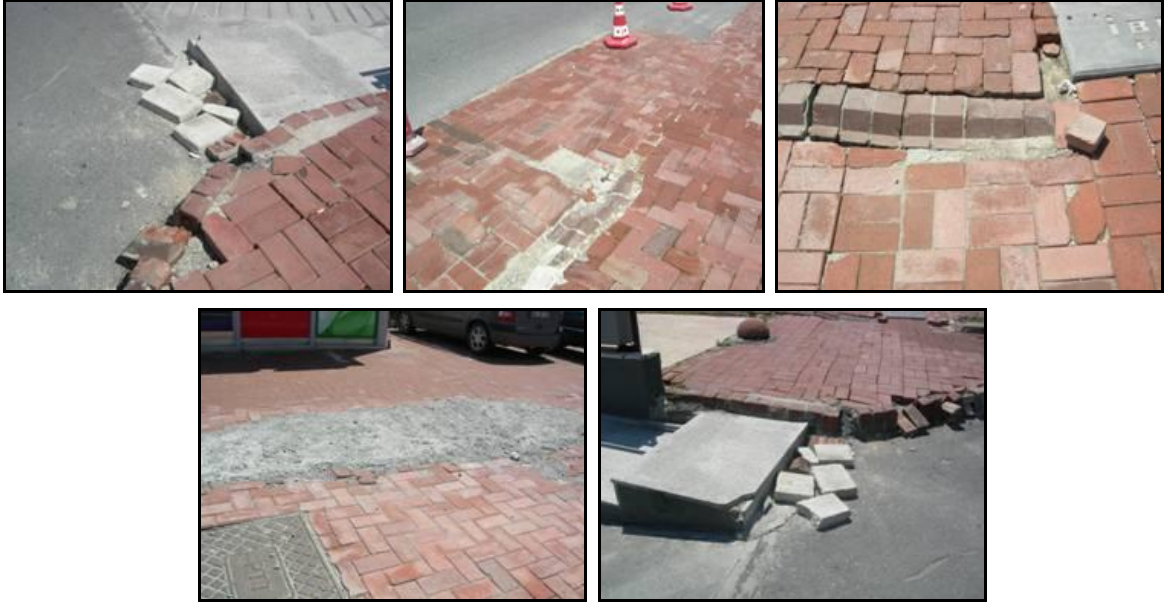
Resim 5.28: Gümüş Caddesi'nde tespit edilen kaldırım deformasyonlarından kaynaklanan engeller
