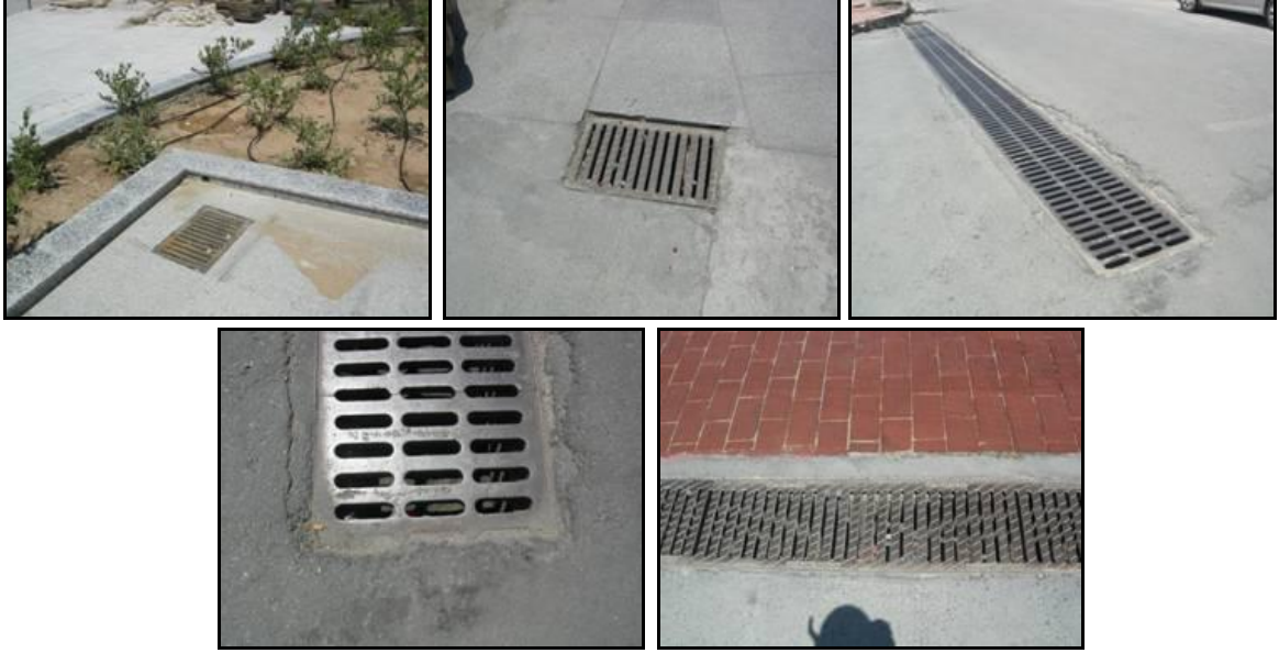
Resim 5.29: Yolda bulunan ızgaraların uygun standart ve durumda olmaması sonucu oluşan engeller
