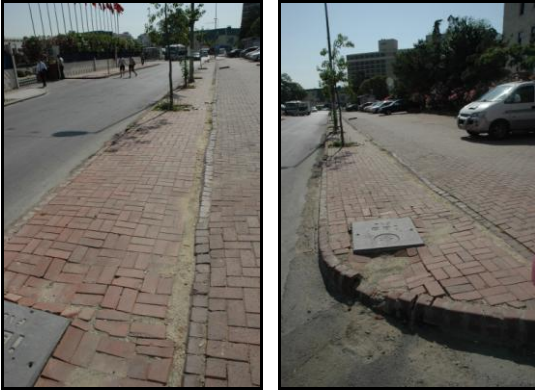
Resim 5. 45: Çalışma alanından yaya yolu ve kaldırım deformasyonları
