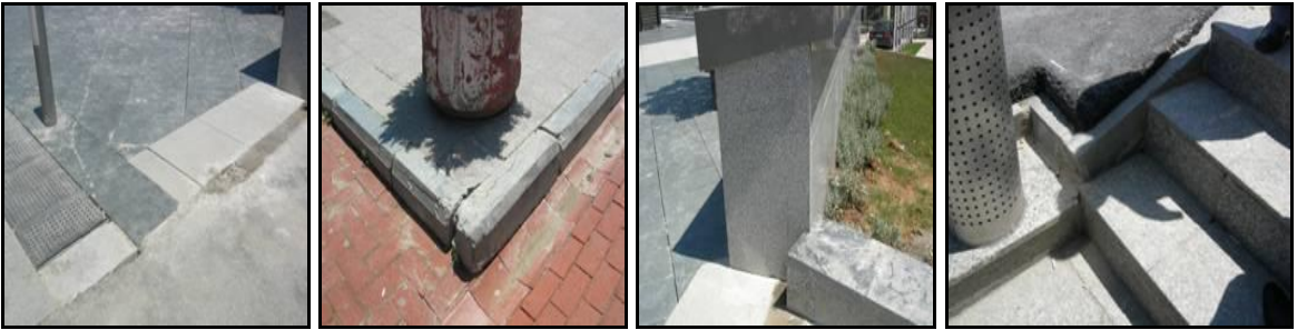
Resim 5.38: Çalışma alanında tespit edilen malzeme birleşim ve uygulama hatalarının erişimi engellemesi
