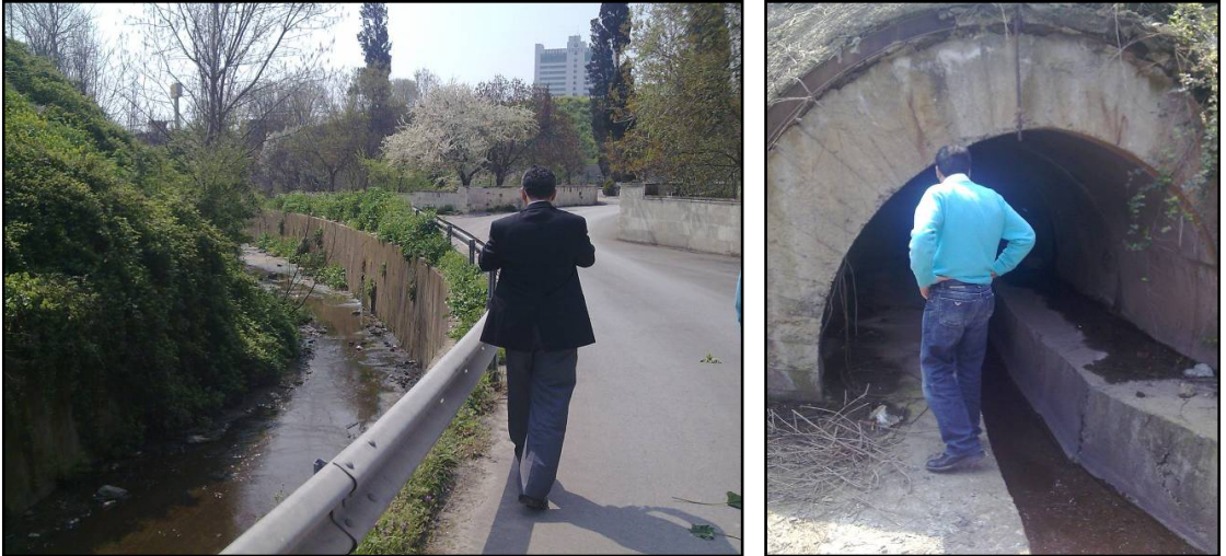
Şekil 5.15 : Seyit Ahmet Deresi mezarlık içinde açık kanala akmaktadır
