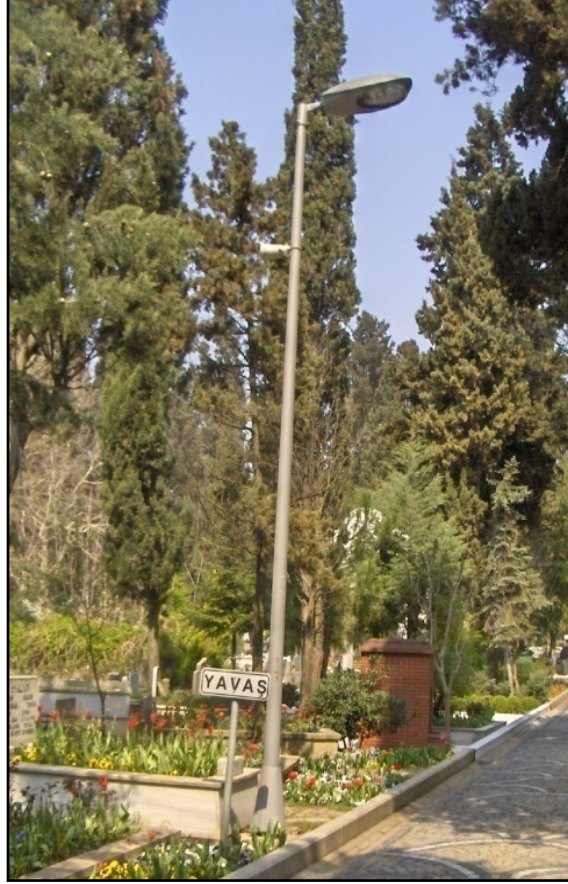
Şekil 5.174 : Aydınlatma direği üzerine yerleştirilmiş ses düzeni
