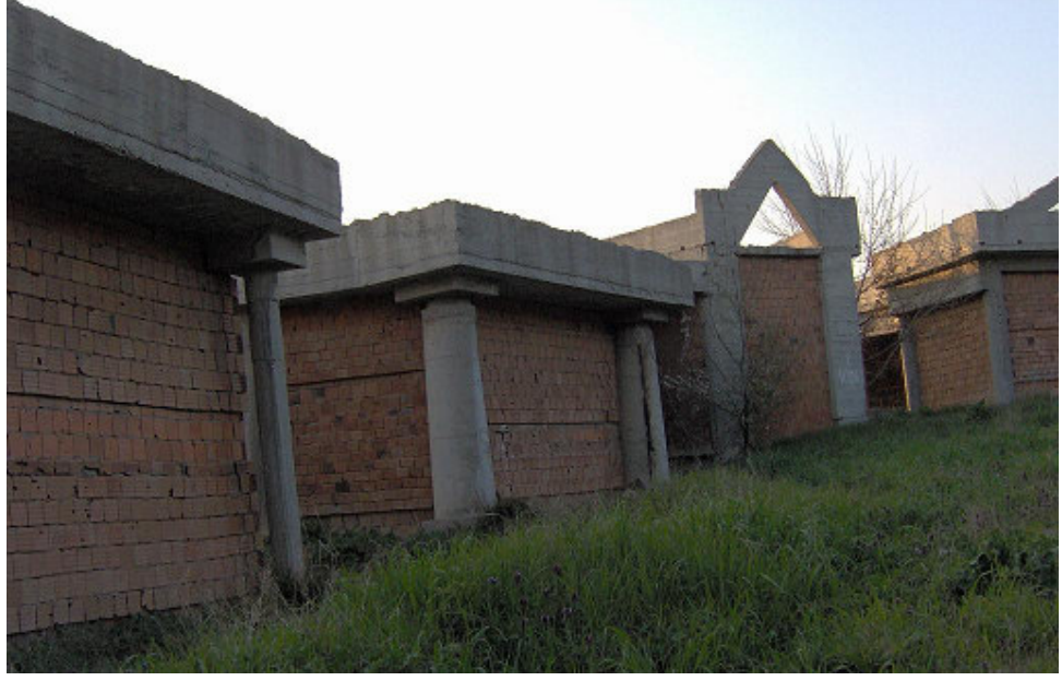
Şekil 4.14. Florya Atatürk Ormanı'nda durdurulan hayvanat bahçesi tesisi sırasında inşa edilen yarım kalmış yapılar
