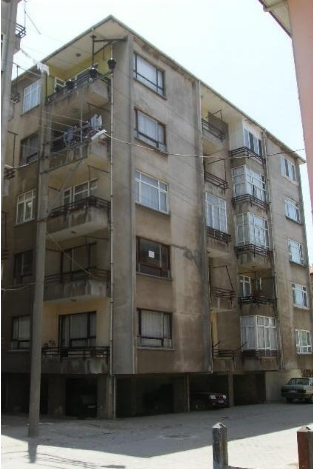
Şekil 5. 4. Bölgedeki yapısal durumu kötü binalara örnek
