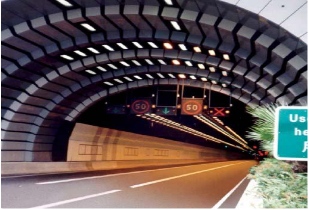
Şekil 3.1: Tünel giriş bölgesi aydınlatması
