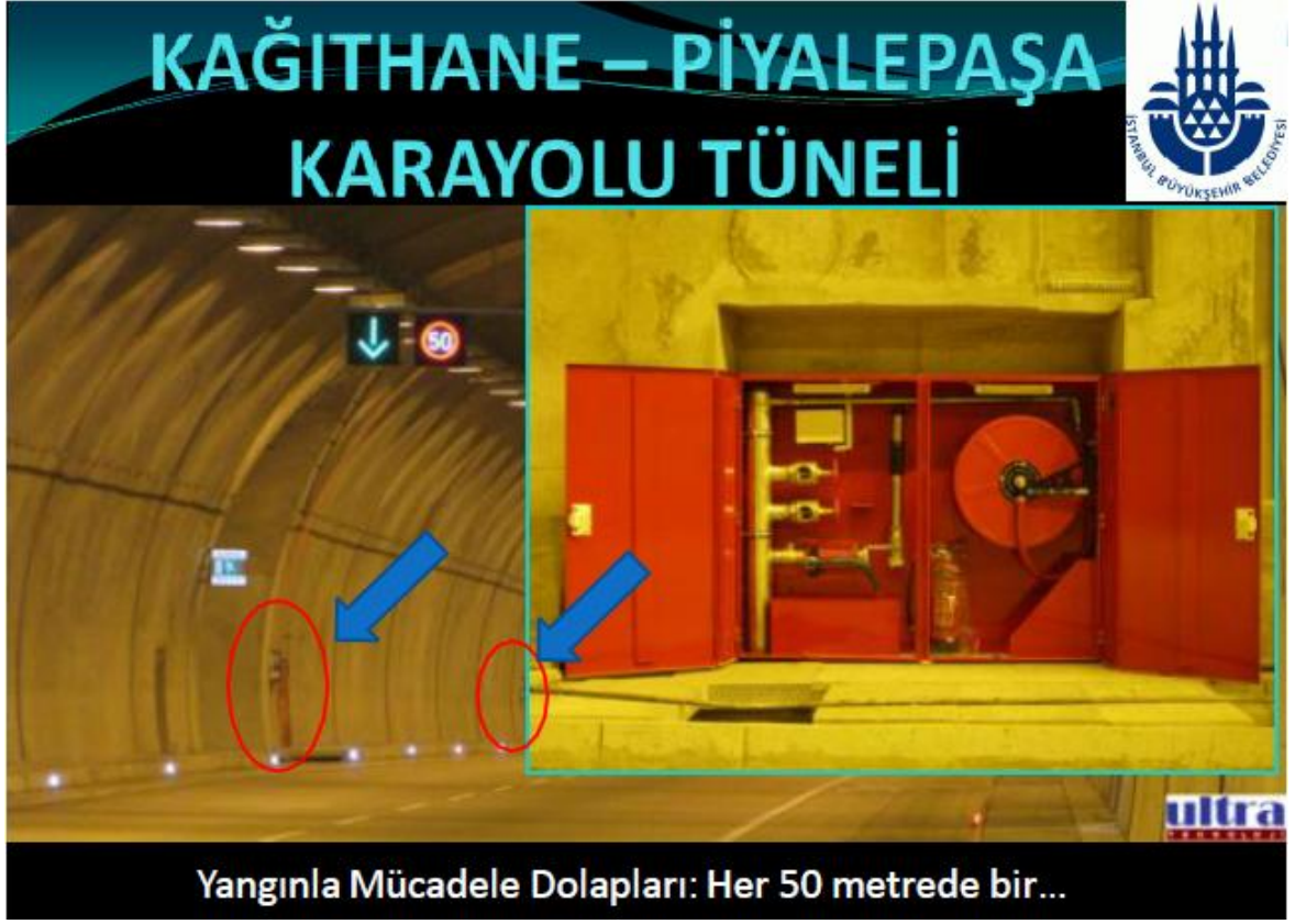
Şekil 4.9: Kağıthane - Piyalepaşa Tüneli yangın sistemi
