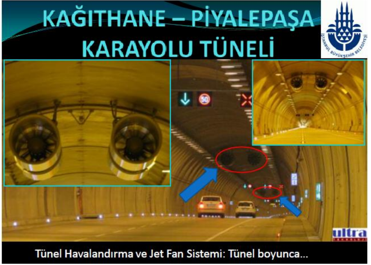
Şekil 4.8: Kağıthane - Piyalepaşa Tüneli jet fan sistemi
