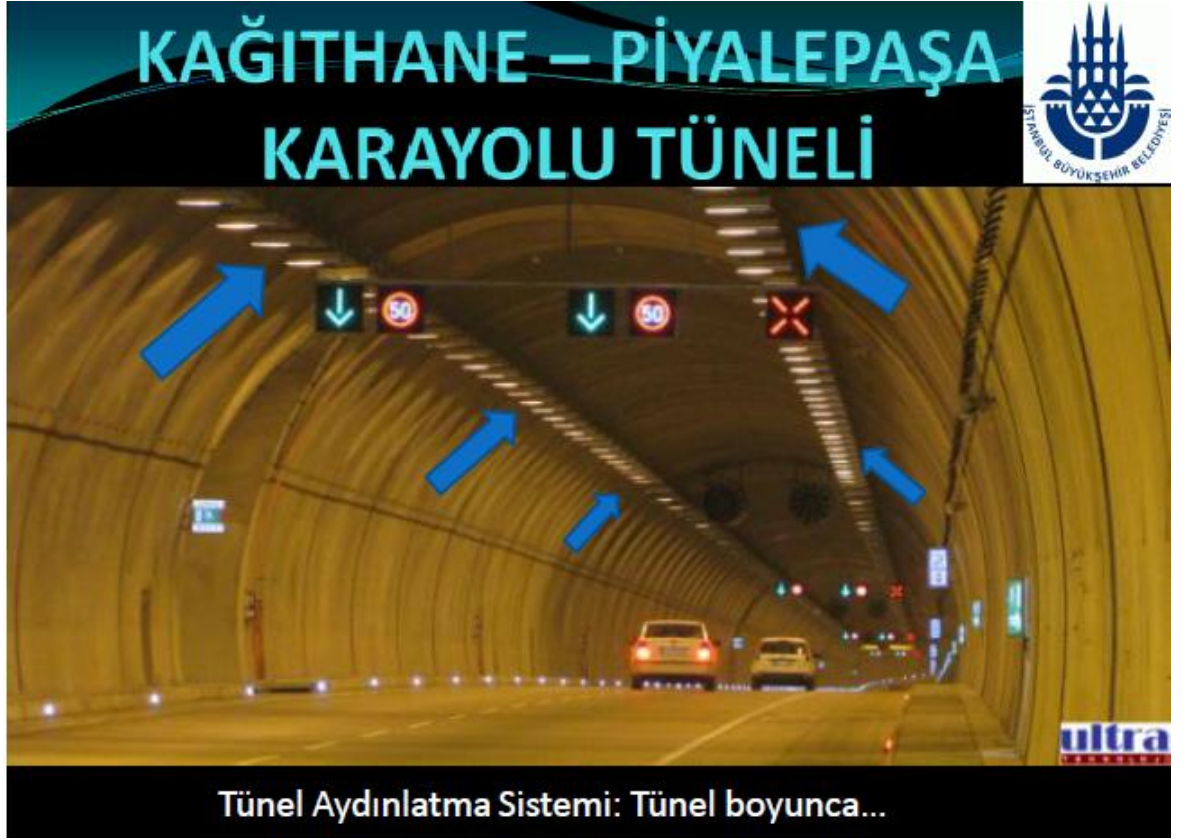
Şekil 4.7: Kağıthane - Piyalepaşa Tüneli aydınlatma sistemi
