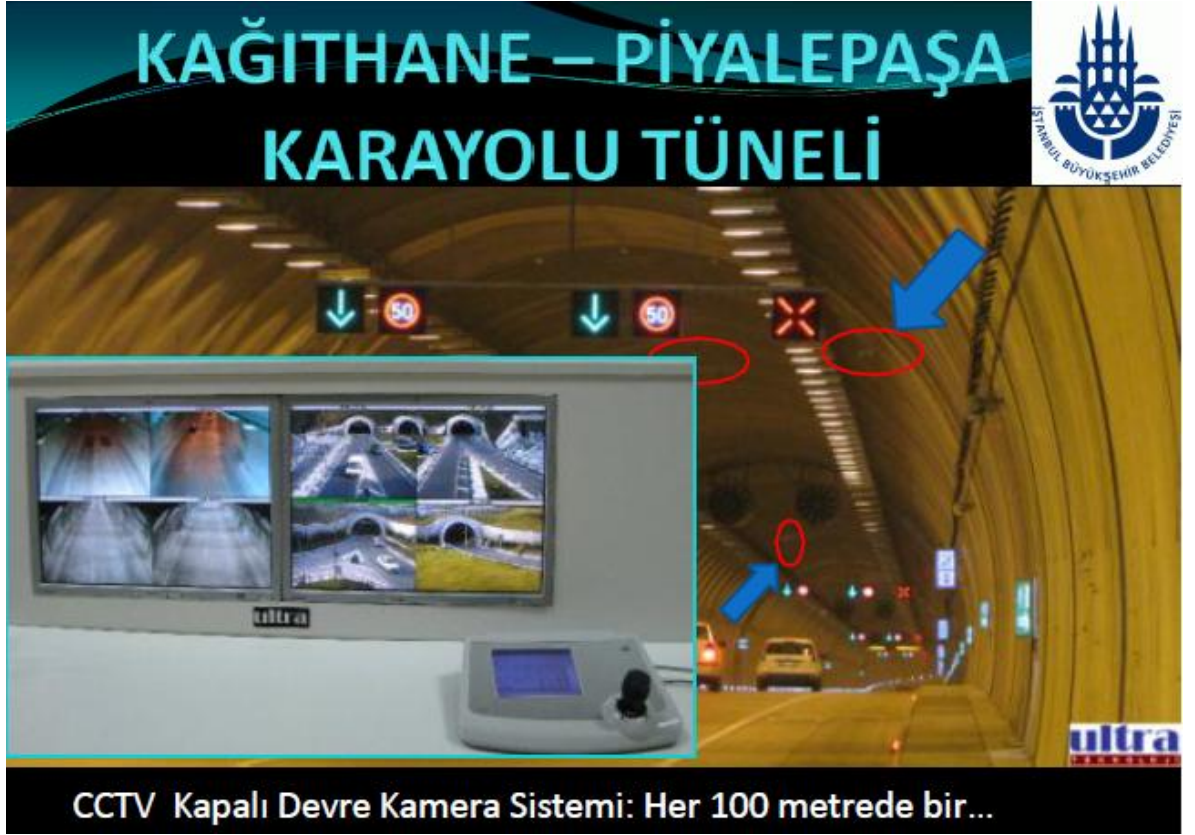
Şekil 4.6: Kağıthane - Piyalepaşa Tüneli CCTV kamera sistemi
