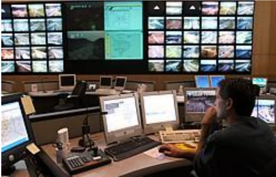
Şekil.5.36: Minneapolis Trafik Kontrol Merkezi
