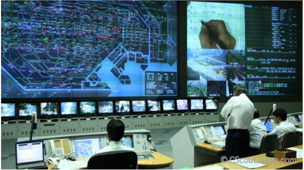
Şekil.5.6: Tokyo Trafik Kontrol Merkezi Kontrol Odası Görüntüsü
